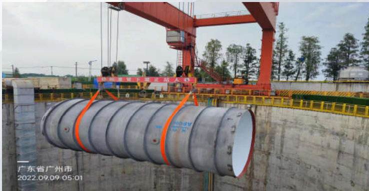
水利管道 HYDRAULIC PIPELINE
